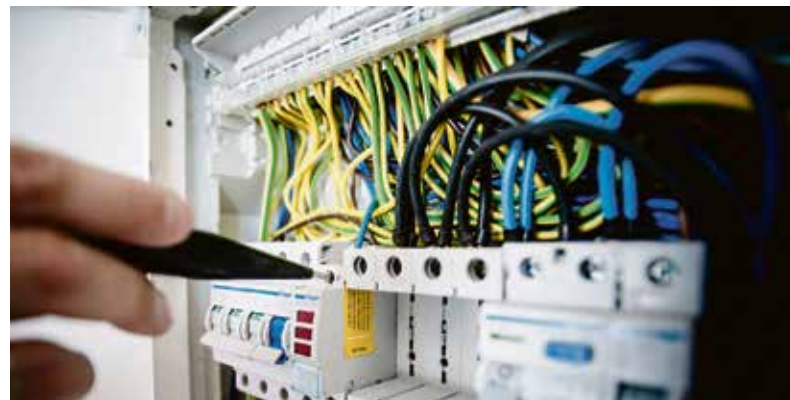
Bei BEKA Elektroanlagen Wriedt wird die gesamte Bandbreite der Elektrotechnik abgedeckt
