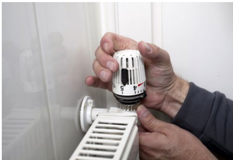
Ein hydraulischer Abgleich sorgt für gleichmäßige Wärme im ganzen Haus
