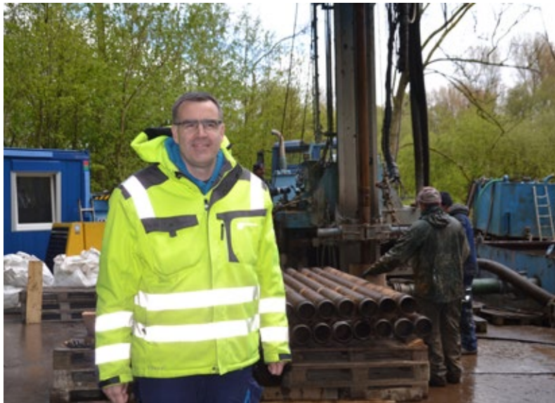
Betriebsleiter Gunnar Bandholz erklärt die Arbeiten vor Ort. Interessierte Leserinnen und Leser lädt er zu Betriebsführungen ins Wasserwerk Schulensee ein.
