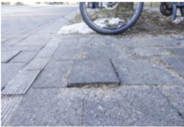
Glasfaser macht alles schneller – und die Fußwege gefährlicher. Schlecht verlegte Platte neben der Bushaltestelle.
