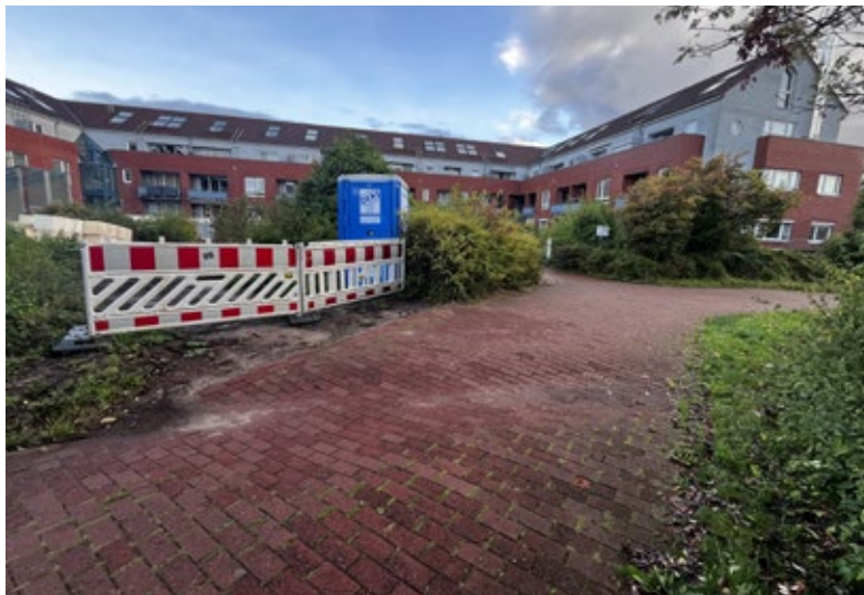
Der Weg im Laubengang ist über die komplette Breite erheblich abgesackt und stellt ein Gefahrenpotenzial für Fußgänger und Radfahrer dar. Foto: Vanessa Baade
