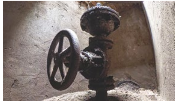
Die Bilder von unten aus dem Schacht werden direkt aufs Smartphone übertragen (ganz links). So wird das Handrad deutlich sichtbar.
